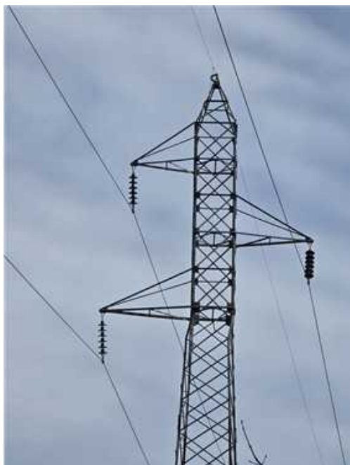
Slika 1. Deformisan stub br. 213
