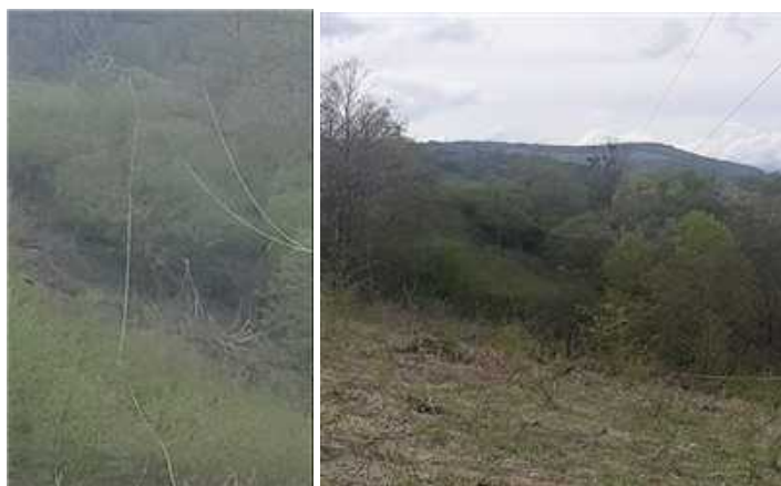
Slika 2. Oštećenja provodnika u trasi DV-a
