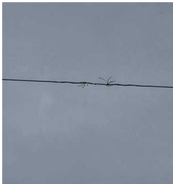
Slika 3. Oštećenje OPGW u rasponu SM 32 - 33
