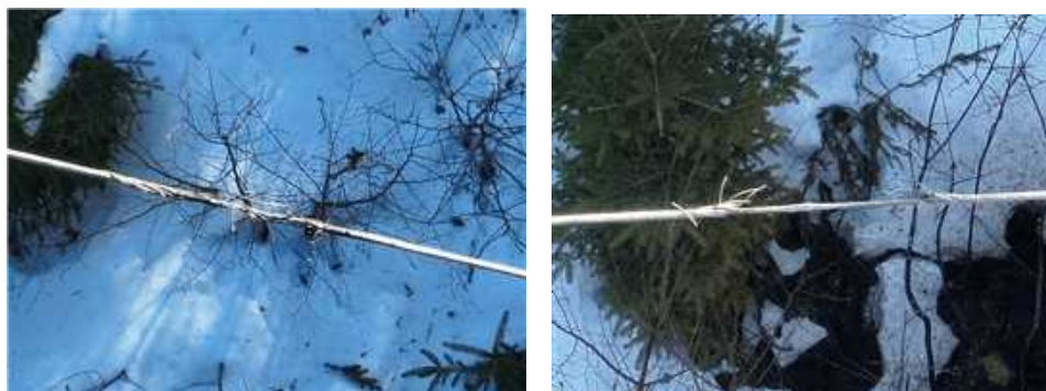
Slika 2. Oštećenja provodnika u trasi DV-a
