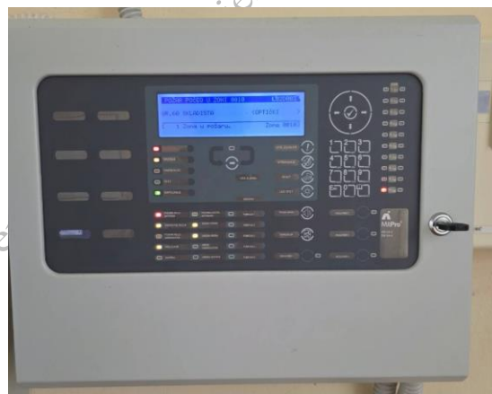
Postojeća vatrodajavna centrala
