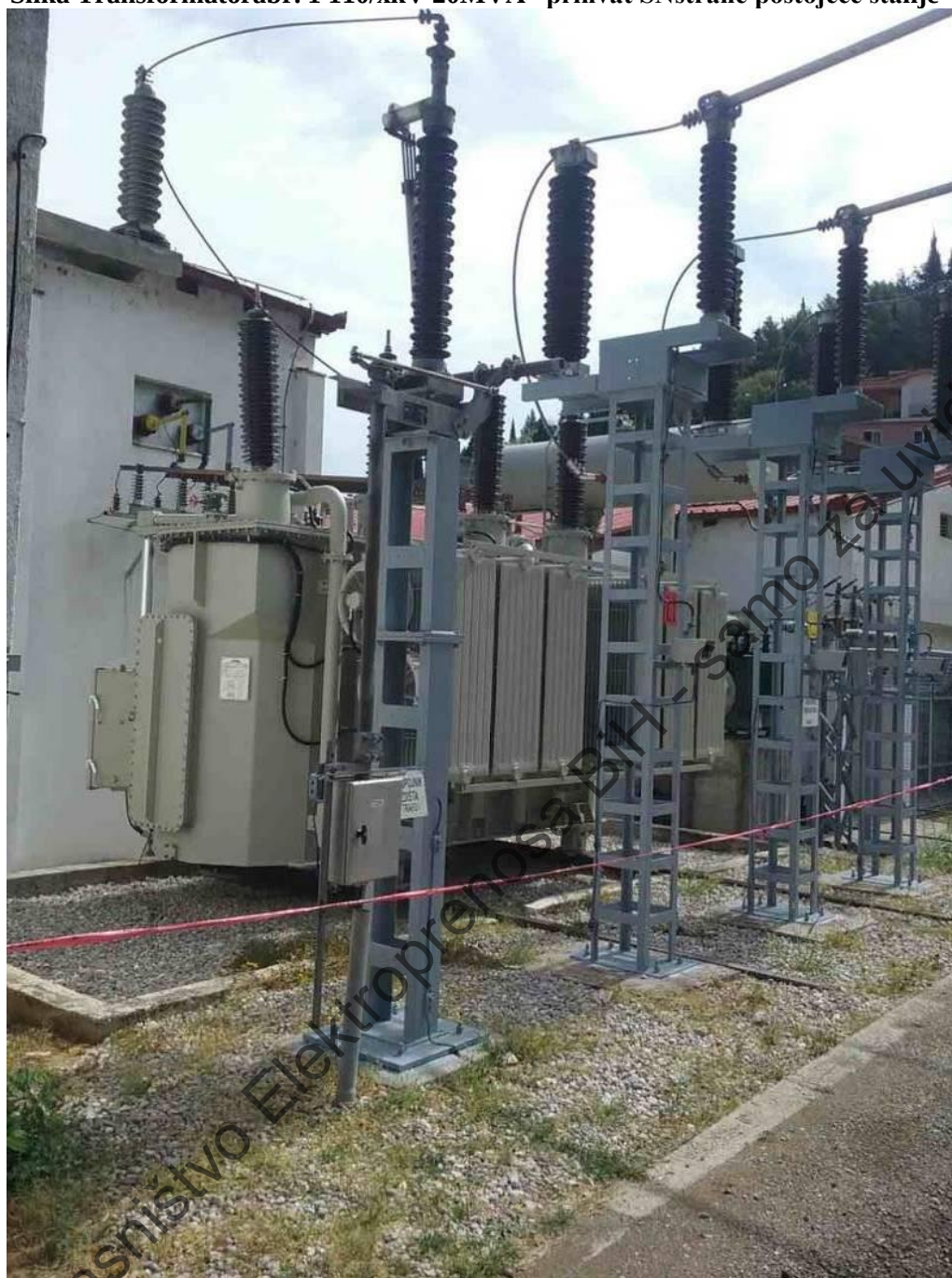
Slika Transformatorabr. 1 110/xkV 20MVA –prihvat SNstrane postojeće stanje -
