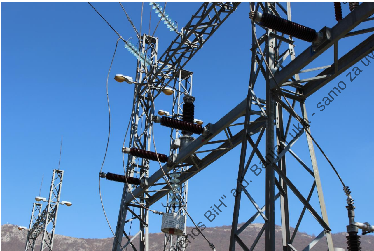
Slika 3. DV 110 kV Jelovača
