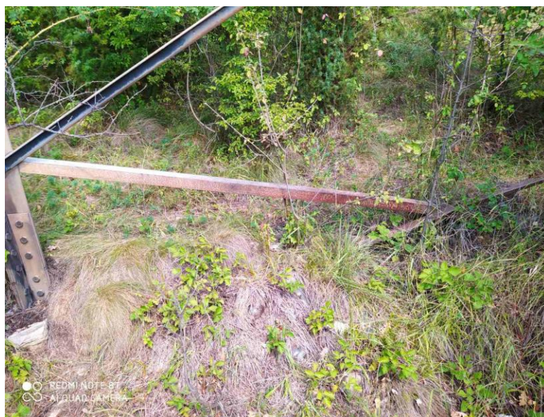
Sl. 6 DV 110 kV TS Visoko – TS Vareš, SM 17 od noge III - IV
