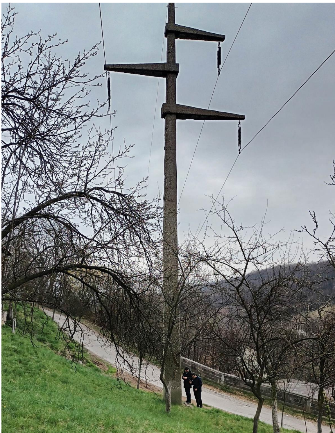
Fotografija 1 – SM 22 na DV 110 kV TS Zenica 1 – TS Travnik 1
