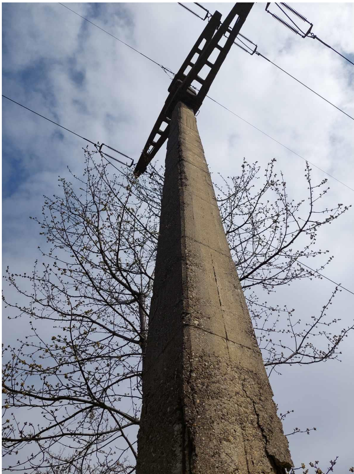
Fotografija 4 – oštećenja SM 23 na DV 110 kV TS Zenica 1 – TS Travnik 1
