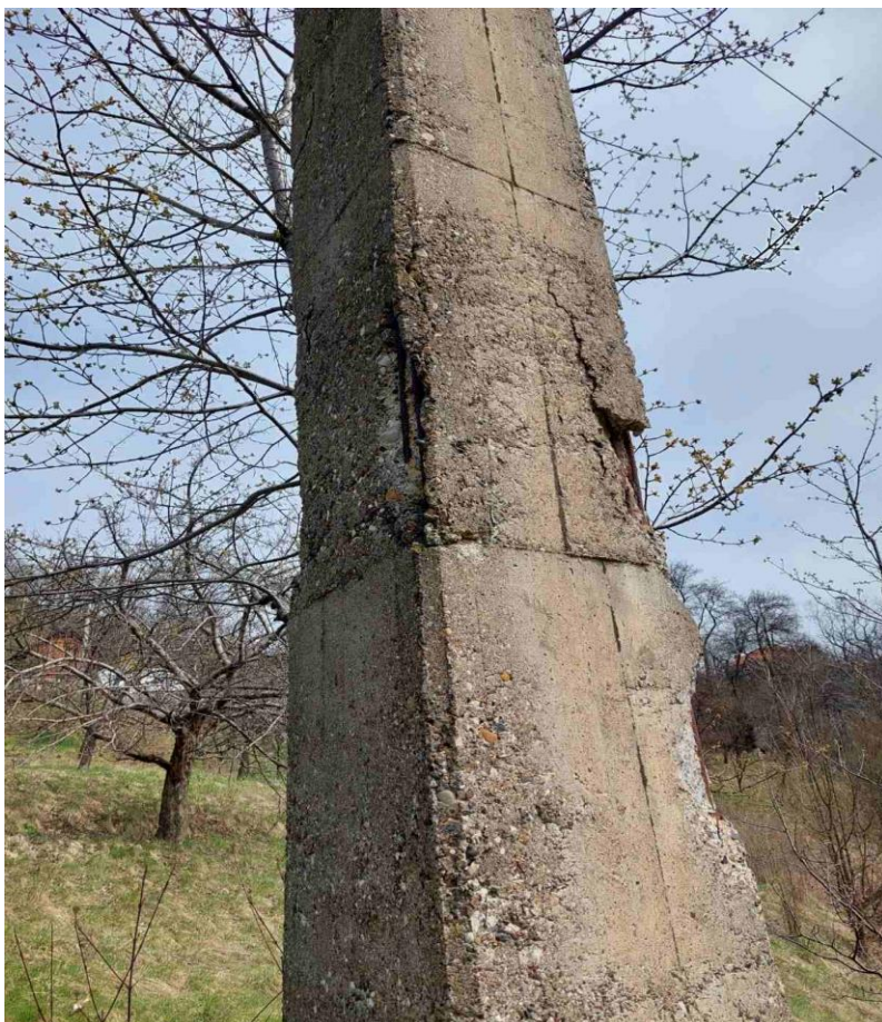
Fotografija 5 – oštećenja SM 23 na DV 110 kV TS Zenica 1 – TS Travnik 1
