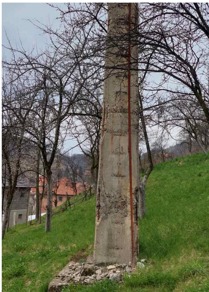
Fotografija 3 – oštećenja SM 22 na DV 110 kV TS Zenica 1 – TS Travnik 1
