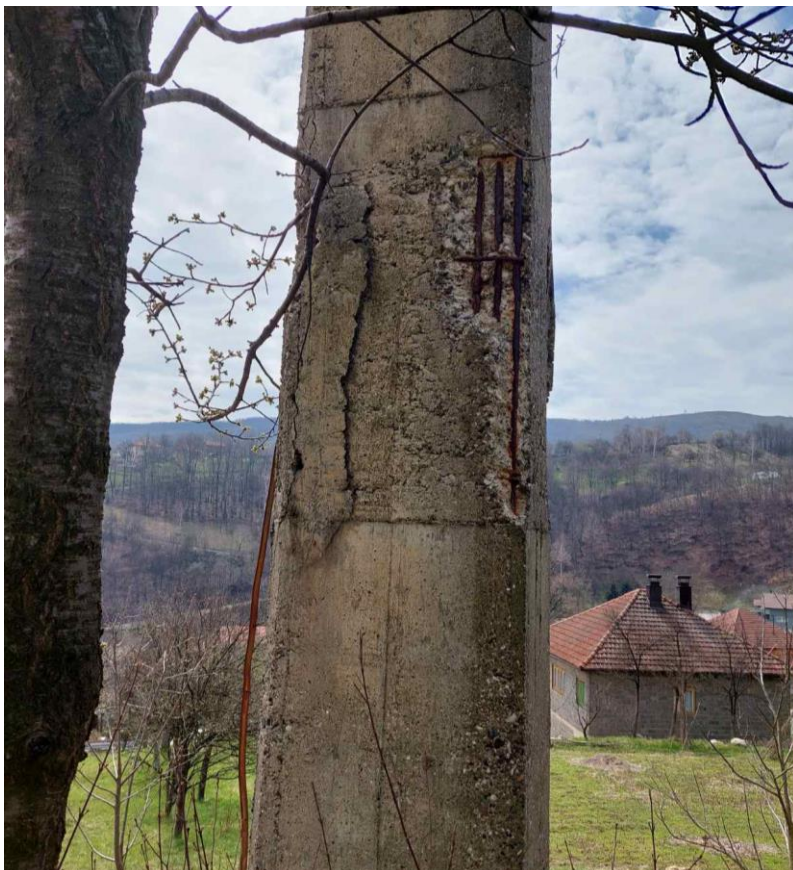
Fotografija 6 – oštećenja SM 23 na DV 110 kV TS Zenica 1 – TS Travnik 1
