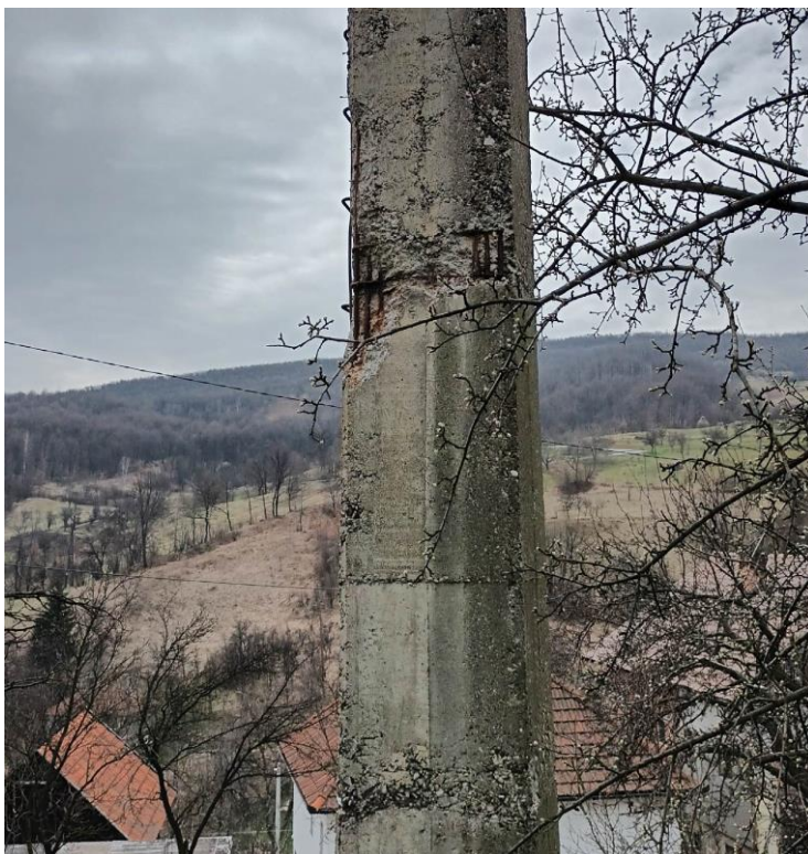
Fotografija 2 – oštećenja SM 22 na DV 110 kV TS Zenica 1 – TS Travnik 1
