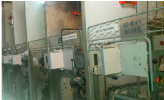
10 kV postrojenje u TS 110/20/10 kV Sanski Most staro 45 godina. Napušteno 2017. godine izgradnjom novog SN postrojenja.
