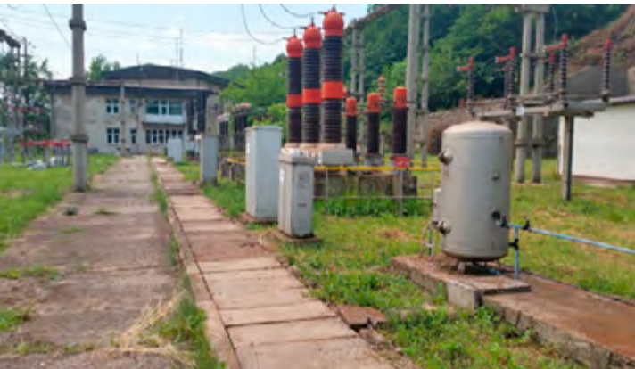
Vanjsko postrojenje 110 kV TS Zenica 1 pogled iz postrojenja prema pogonskoj zgradi
