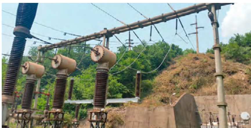
TS Zenica 1 - Novi potporni izolatori i veze prema sabirnicama
