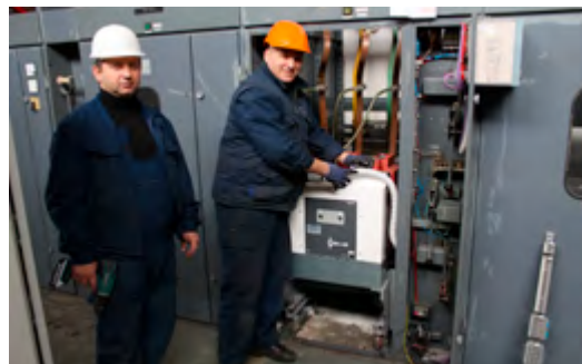
Novougrađeni vakuumski prekidač
