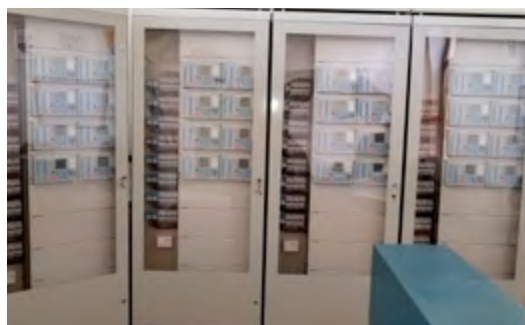
Slika 6. KRO za 10 kV odvode nakon zamjene
