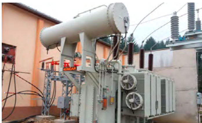
Novi energetski transformator T2 prenosnog odnosa 110/35/10 kV
