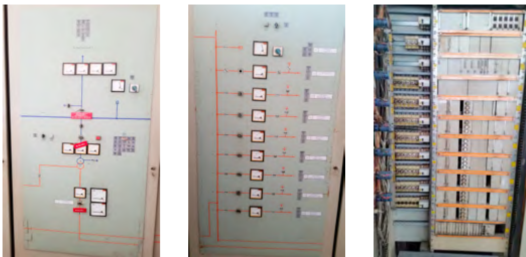
Slika1. Dio sistema zaštite i upravljanja koji je bio predmet zamjene
