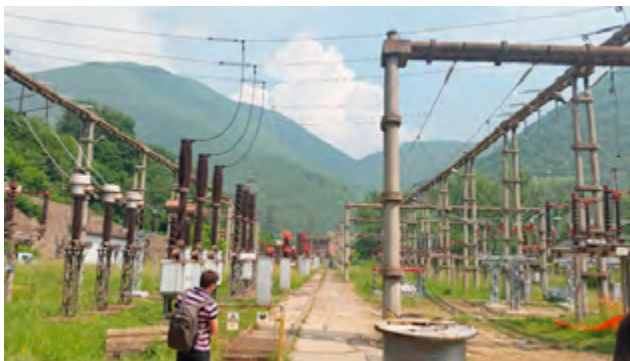
TS Zenica 1 – Postrojenje 110 kV
