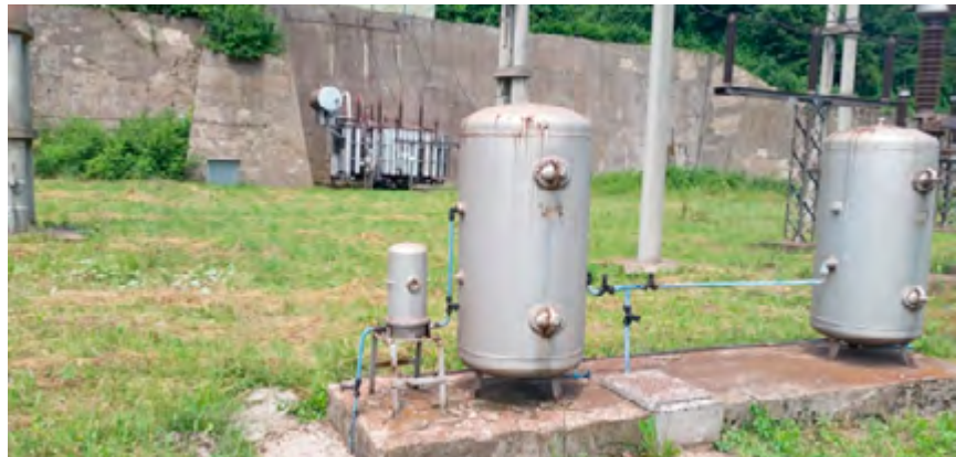
Potebna postepena zamjena zrakovodnog sistema za rastavljače i prekidače
