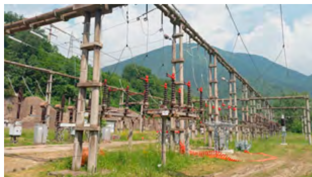
TS Zenica 1 – Novi rastavljači i SMT u vanjskom postrojenju
