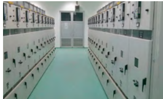
Novo SN postrojenje 10 i 20 kV u TS 110/20/10 kV Sanski Most. Pušteno pod napon 2017. godine.
