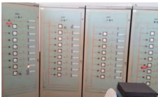
Slika 5. KRO za 10 kV odvode prije zamjene
