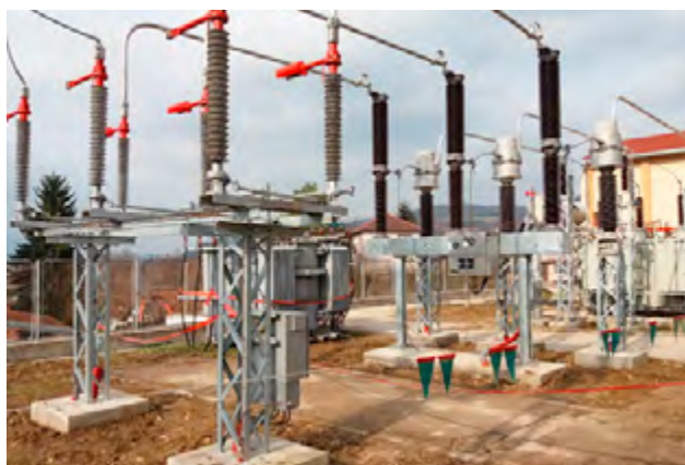
Novoizgrađeno transformatorsko polje T2 110 kV u TS Kiseljak
