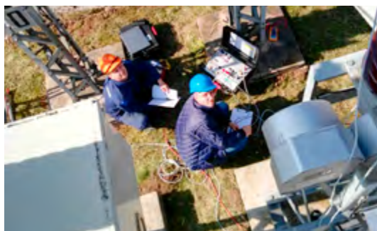
Ispitivanje sinhronizma 110 kV prekidača
