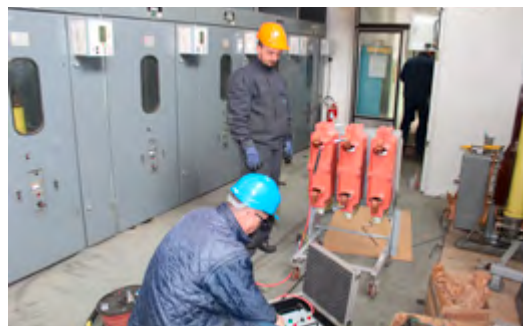
Ispitivanje vakuuma novog prekidača
