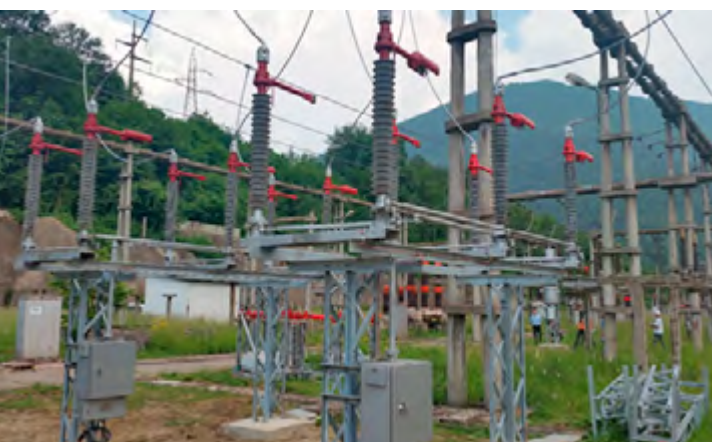
Novougrađeni sabirnički rastavljači 110 kV
