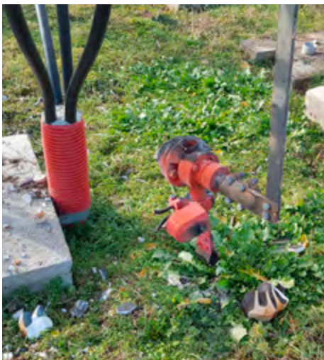
Oštećeni dio izlaznog rastavljača 35 kV
