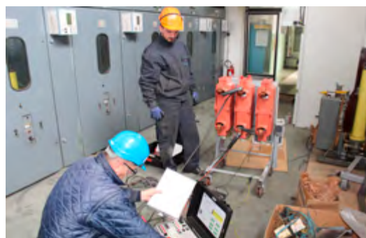
Ispitivanje pada napona novog prekidača
