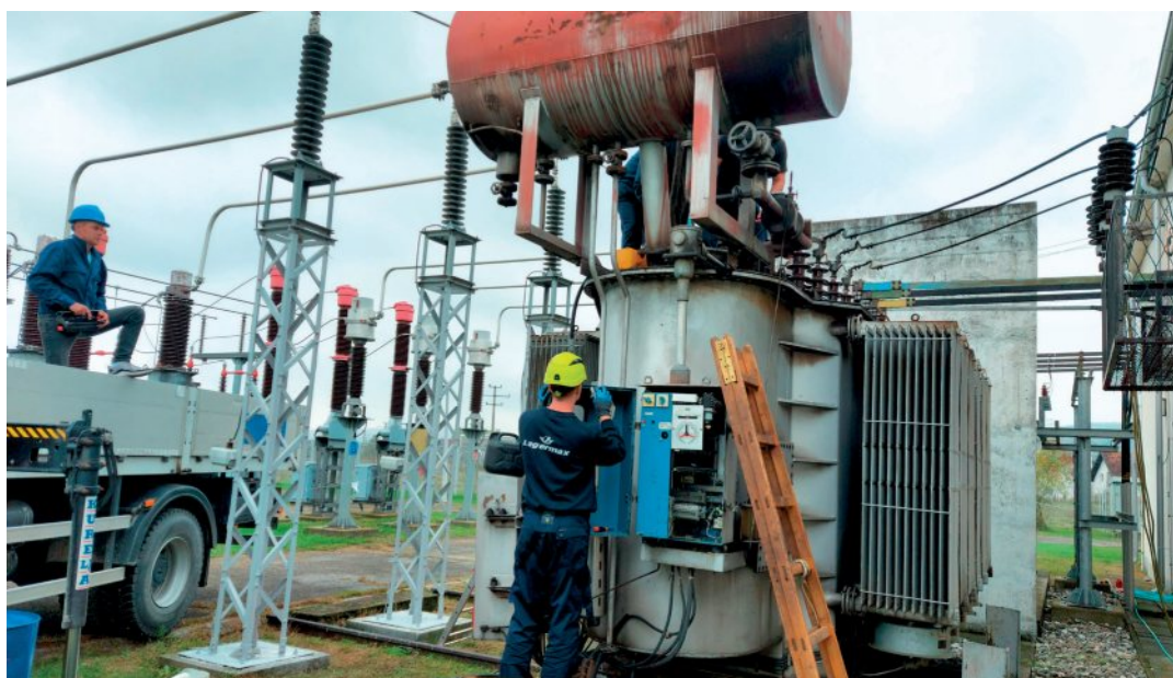
Rad na pogonskom mehanizmu regulacione sklopke na TR 1 u TS 110/x kV Modriča
