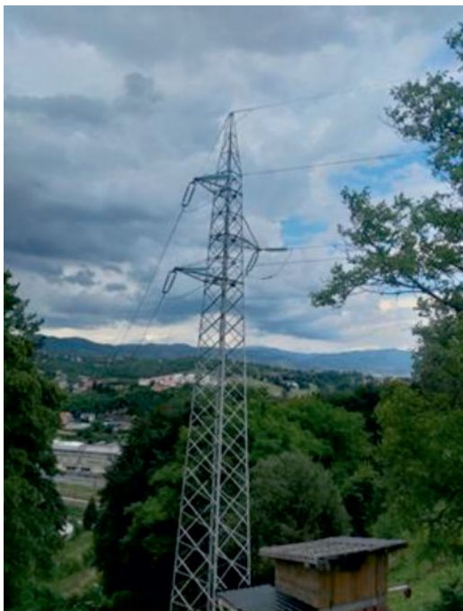
SM 7 nakon završene sanacije. Elektromontažne radove izvodili su uposlenici TJ Sarajevo i TJ Zenica.
