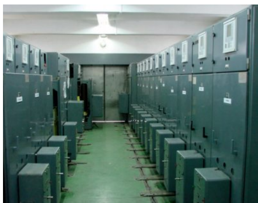
Старо 10 kV постројење
