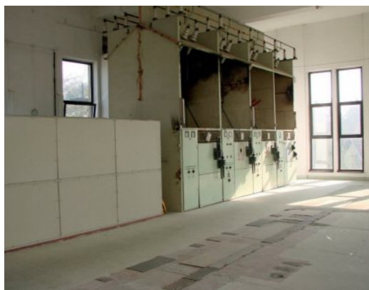
Старо зидано 35 kV постројење и металом оклопљене 35 kV ћелије „Кончар“ у погонској просторији
