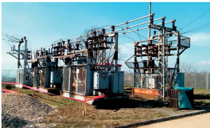
Staro postrojenje 35 kV vanjske izvedbe
