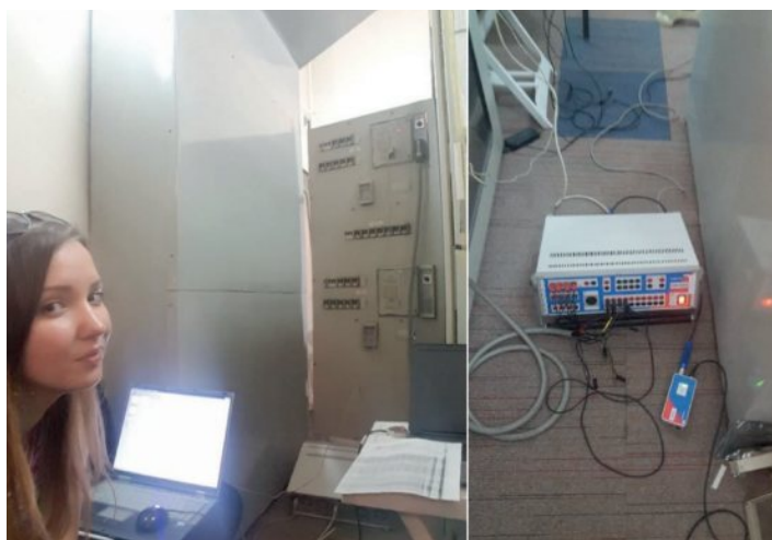
Samostalni inženjer za MRT i PN Zana Garaplja u TS Sarajevo 7 Aktiviranje i puštanje u rad teleprotection funkcije za DV 110 kV Sarajevo 7 – Sarajevo 13
