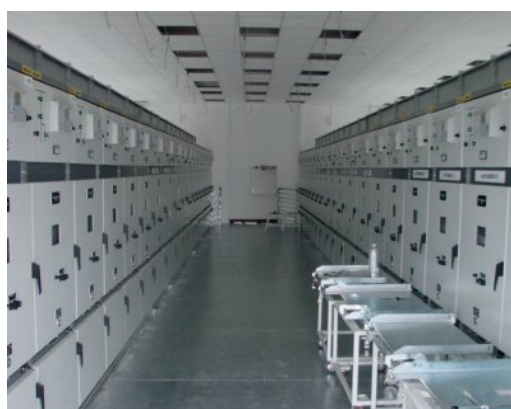
Ново СН постројење на челичнорешеткастој конструкцији
